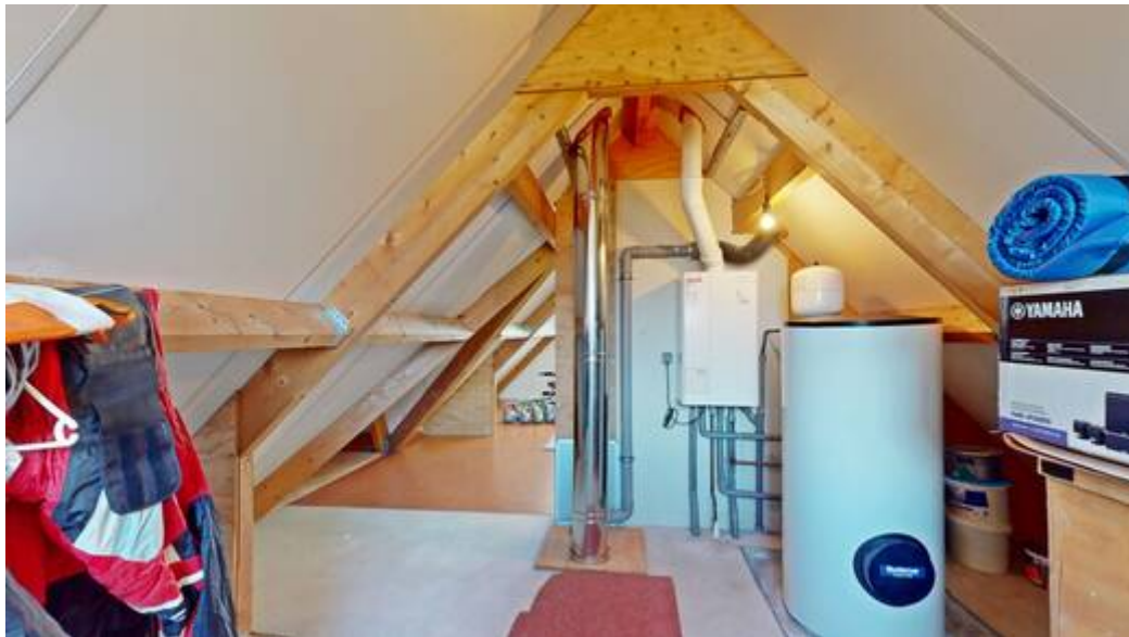
Heizung im Spitzboden
