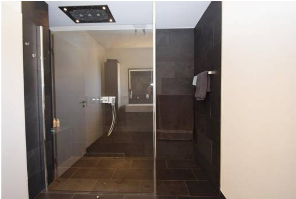
Bodengleiche Regendusche im Glasmantel
